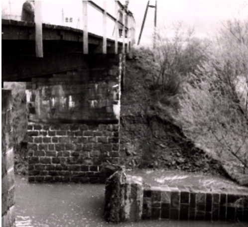
Durch das Hochwasser 1959 zerstörter Brückenpfeiler der Lieserbrücke bei Daun
